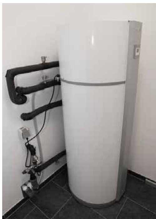
Jordvarmepumpen i kælderen
