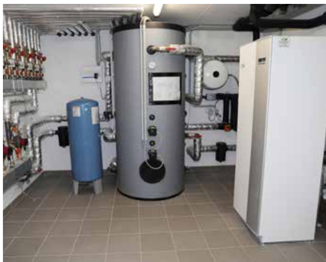
Jordvarmepumpen i kælderen.
