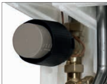
Reguleringsventil til brugsvandstemperatur.
